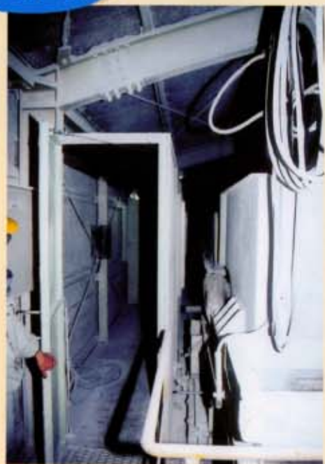
選鉱プラントでの作業時に従業員が騒音にさらされるため作業用通路の壁及び天井に遮音材を用い騒音を緩和した。
