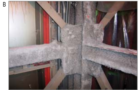
B エレベーターシャフト内(竖穴区画の吹きつけ石綿)。この閉ざされた空間をエレベーターは高速で何回も上下しているため粉じんが舞っているものと推測出来ます。修理、点検時に作業員が区画内に立ち入り、堆積した石綿粉じんが再飛散してばく露する可能性があります。
