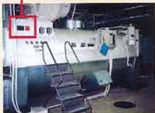
ターボ冷凍機
