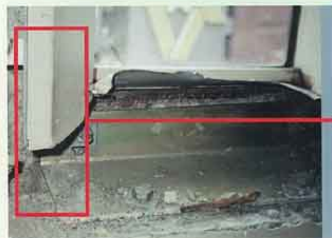
結露防止用吹付け石綿・石綿含有吹付けロックウール（カーテンウォール裏等）
