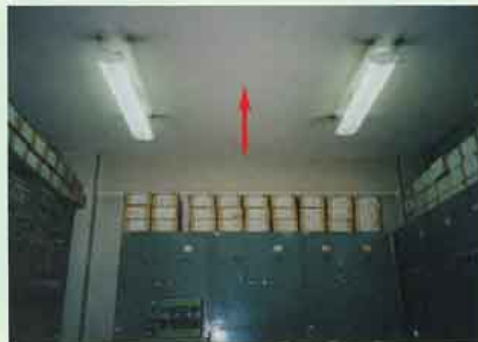
結露防止用の石綿含有バーミキュライト吹付け・パーライト吹付け（天井・壁等）
