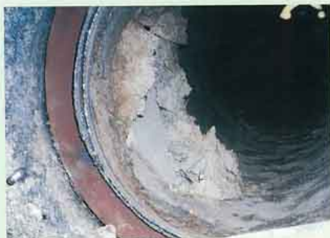
煙突断熱材（ライニング）
