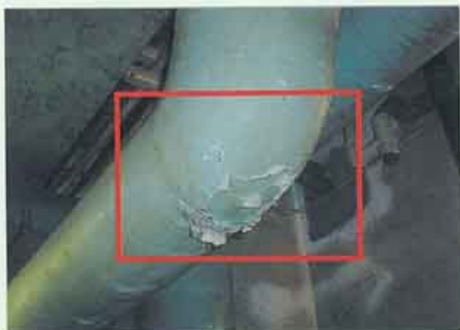
石棉含有保温材（配管曲がり部）
