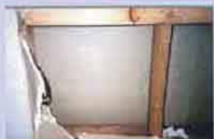
砒素・カドミ含有石膏ボード
