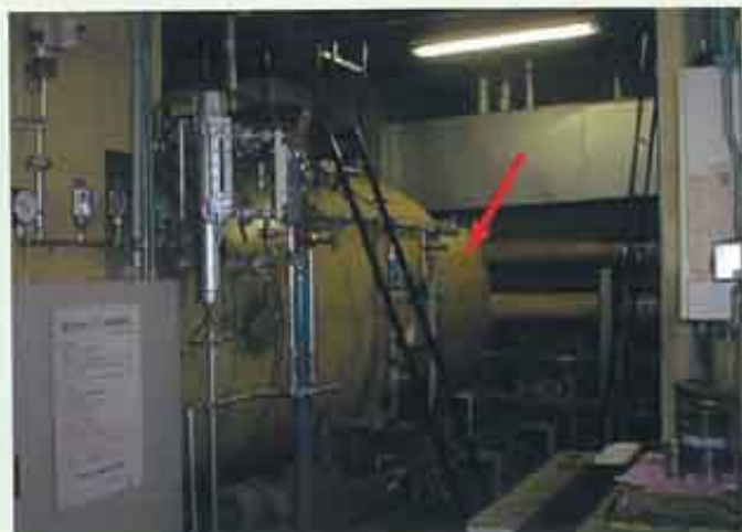
石棉含有保温材（ボイラ外周部）
