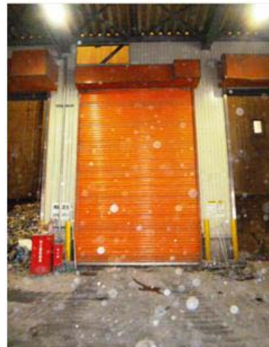
ピット前シャッター
